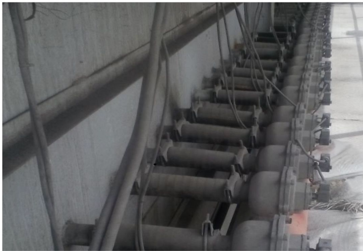
اجرای جت فیلتر و اتوماسیون فیلترینگ
